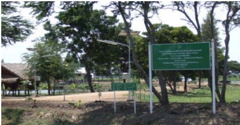
ระบบผลิตไฟฟ้าแสงสว่างทางสาธารณะด้วยเซลล์แสงอาทิตย์
