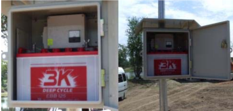
อุปกรณ์ควบคุมและแบตเตอรี่
